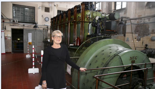
■ Man würde es dem Haus von außen nicht ansehen, aber es erstreckt sich über sechs Etagen. Um es bombensicher zu machen, befinden sich die wichtigen Räume unterirdisch. Von dieser Notstromanlage gibt es nur vier Exemplare. Sie ist voll funktionsfähig.
