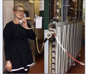
■ Die meterhohe Telefonanlage ist immer noch in Betrieb.
